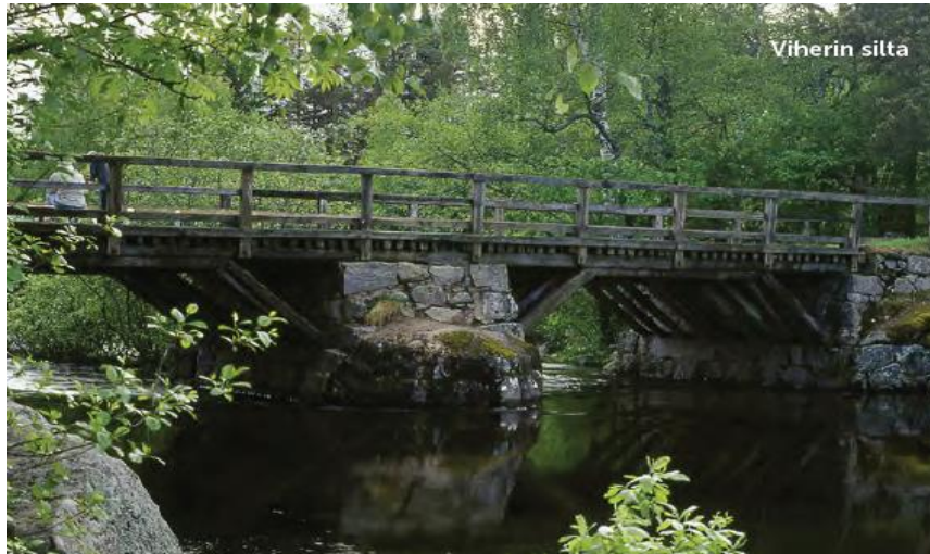
Kuva 10. Viherin silta Joutsassa on rakennettu vuonna 1887, ja se on puinen kaksiaukkoinen tukiansasilta. [8.]
